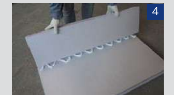
Нанести КЛЕЙ-ПІНУ для пінополістиролу на плити теплоізоляції, встановити торцеву плиту. Для надійного кріплення необхідно з'єднати плити одна з одною через 5-7 хвилин після нанесення клею.
